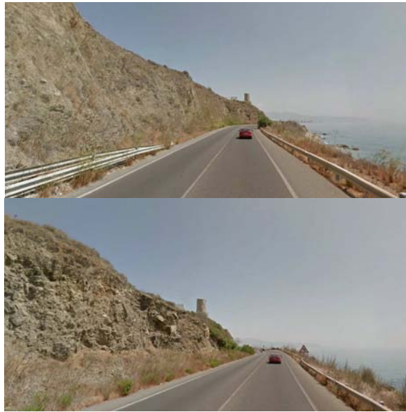
Figura 2. Imágenes actuales de la costa en el tramo sin protección junto a PT-2.
