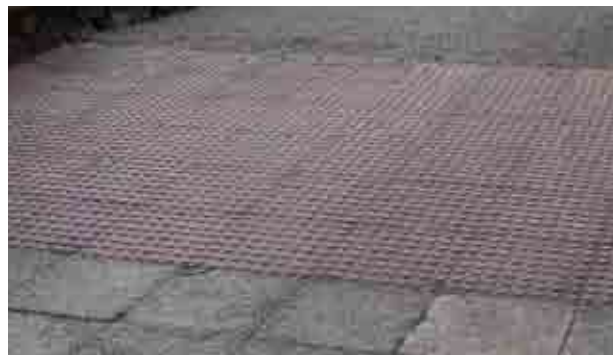
Figura 15. Características de la baldosa de botón existente.
