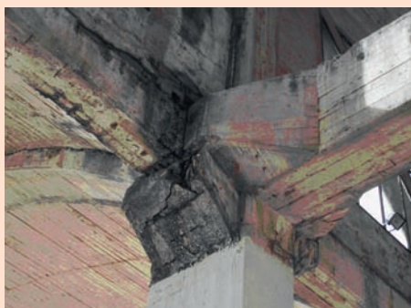
Fisuras por rotura de ménsula.
