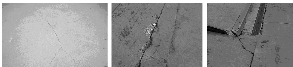
Fisuras generalizadas, fisuras en junta no marcada y apoyo diferente y fisuras en torno a puntos duros.
